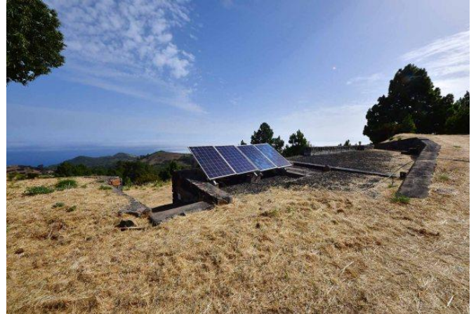
Photovoltaikanlage für die Stromversorgung
