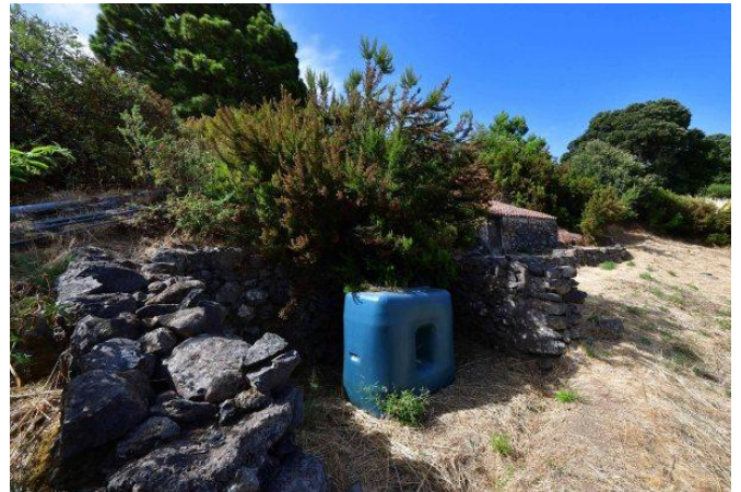
Trinkwassertank, teilweise hinter Natursteinmauer verborgen
