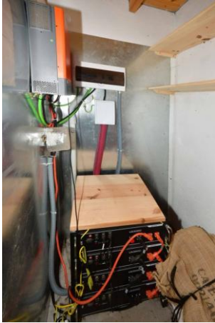
Technikraum am Haupthaus
