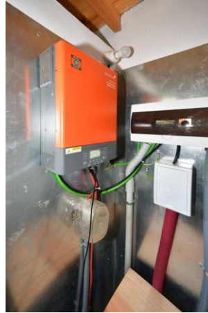
Technikraum am Haupthaus
