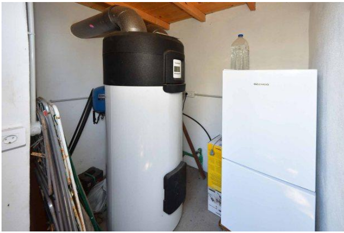
Technikraum am Haupthaus
