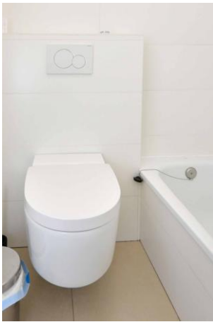
Badezimmer 3, wandhängendes WC
