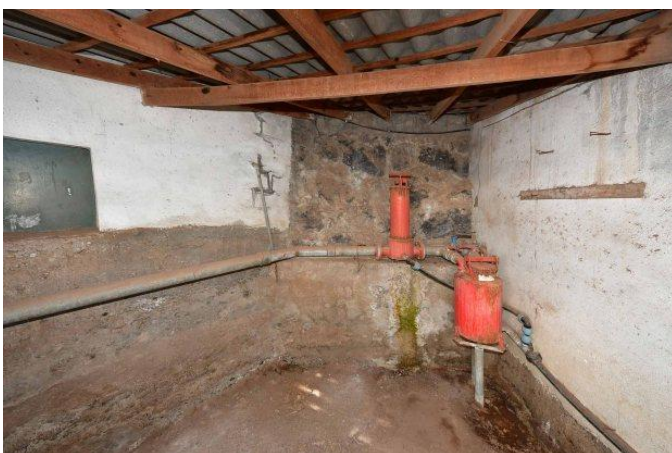
Technikraum mit Wasserfiltern für die Gartenbewässerung
